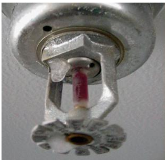
Elfagyott sprinkler szórófej [8]
