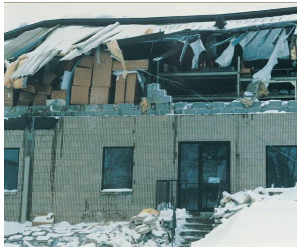
Téli viharban megrongálódott tetőszerkezet [9]
