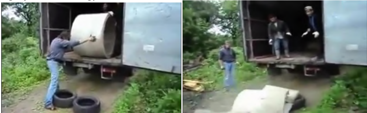
11. kép: Betongyűrű esésének sikertelen tompítása [14]
